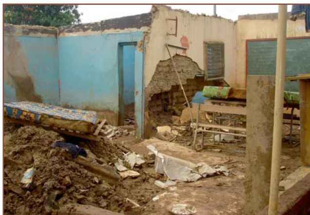
L'entrepôt et une salle de cours de soutien ont été détruits
