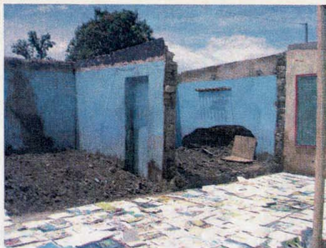
Le siège de l'association "Polemdé" offre désormais le triste spectacle d'une maison effondrée et des livres irrécupérables.
