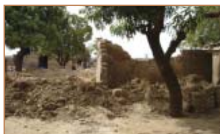
Le mur effondré de la cour de la biblio. Derrière plusieurs habitations ont été démolies.
